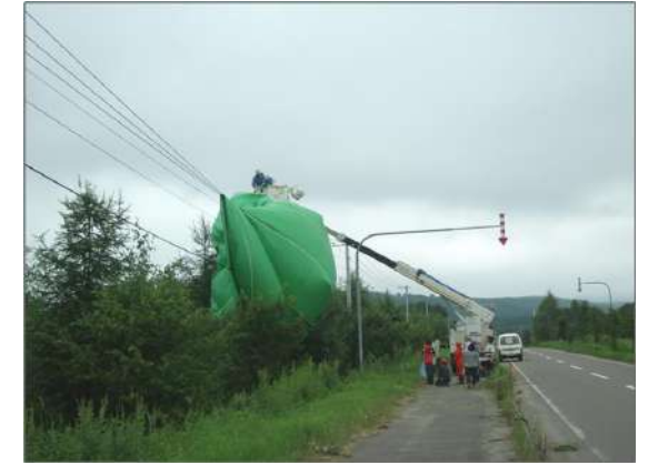
写真:配電線に接触(撤去作業)
